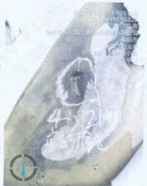
图 7.3 渗漏破损处图片
