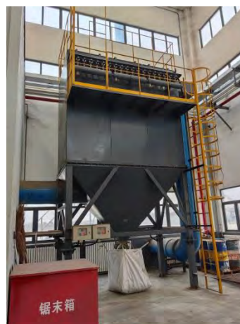
固化车间除尘设施
