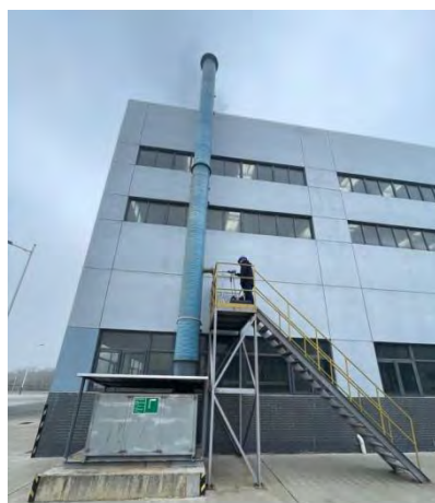
固化车间废气排气筒
