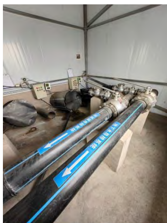
渗滤液排至收集池管道
