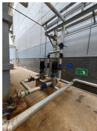
渗滤液预处理系统排口（DW004）
