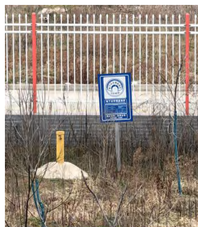
2#地下水监测井
