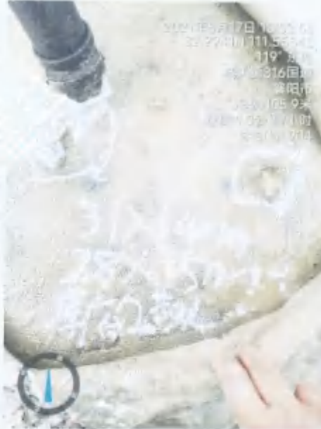
图 7.2 渗漏破损处图片
