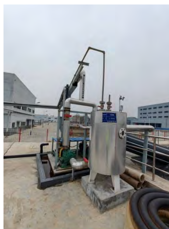
渗滤液收集池输送泵
