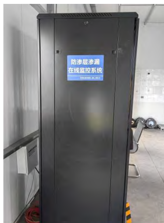
渗滤液监测系统
