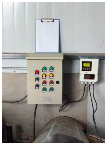
地下水导排流量计及记录表
