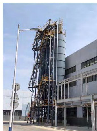
灰库、水泥库仓顶除尘设施
