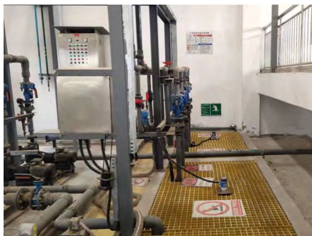
厂区污水总排放口（DW002）
