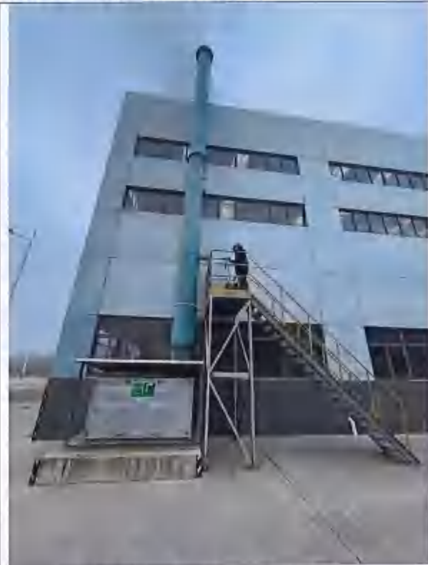
(1) 有组织废气现场采样照片
