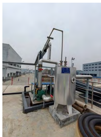
渗滤液收集池输送泵
