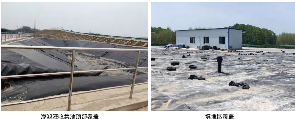
图 5-4 废气污染防治措施照片
